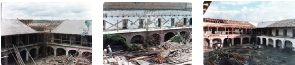
Figura 4. Claustro La Encarnación después del terremoto de 1983 Fuente: Archivo Institución Universitaria Colegio Mayor del Cauca
